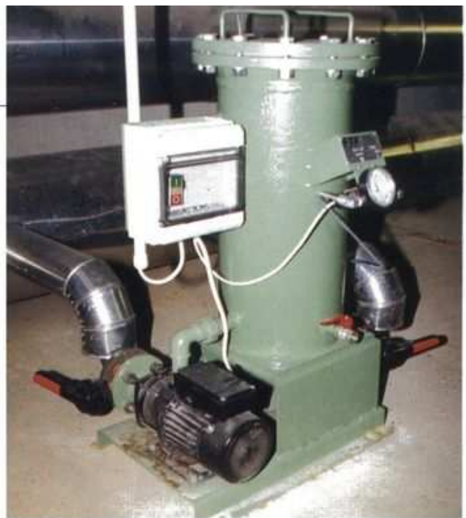
Feinstfilteranlage für Terminal 4 im Hamburger Airport.
